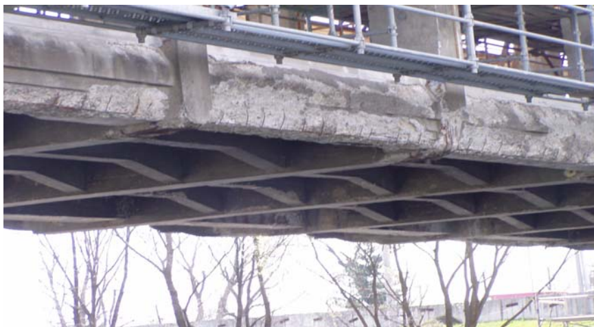
Obr. č.1 Degradace konstrukce mostu
