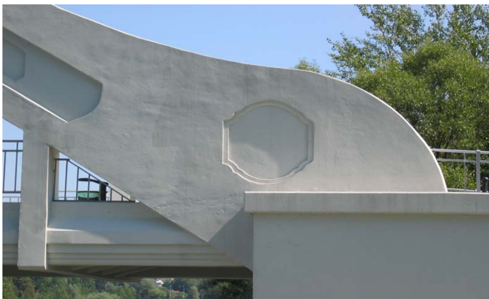
Obr.č.5 Názorná ukázka sanované žb. mostní konstrukce
