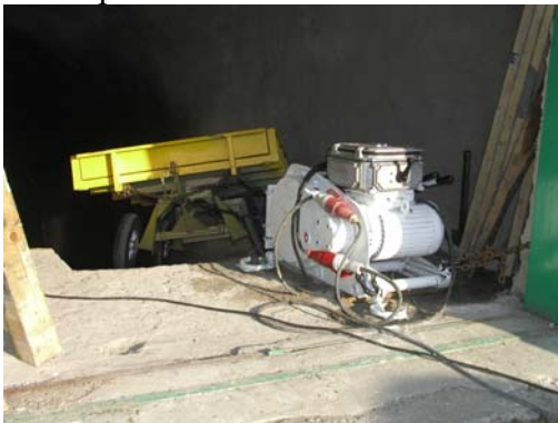
Vrátek VTA 1000 na zhlaví úpadnice a speciální dopravní vozík
