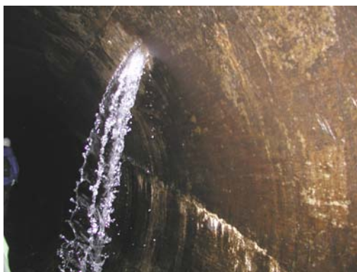
Předmětný přítok vody před utěsněním vydatnost přítoku činí 2,86 l / sec
