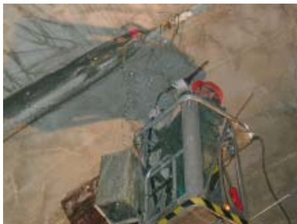
Předtěsnění silného výronu vody ze spáry sekci
